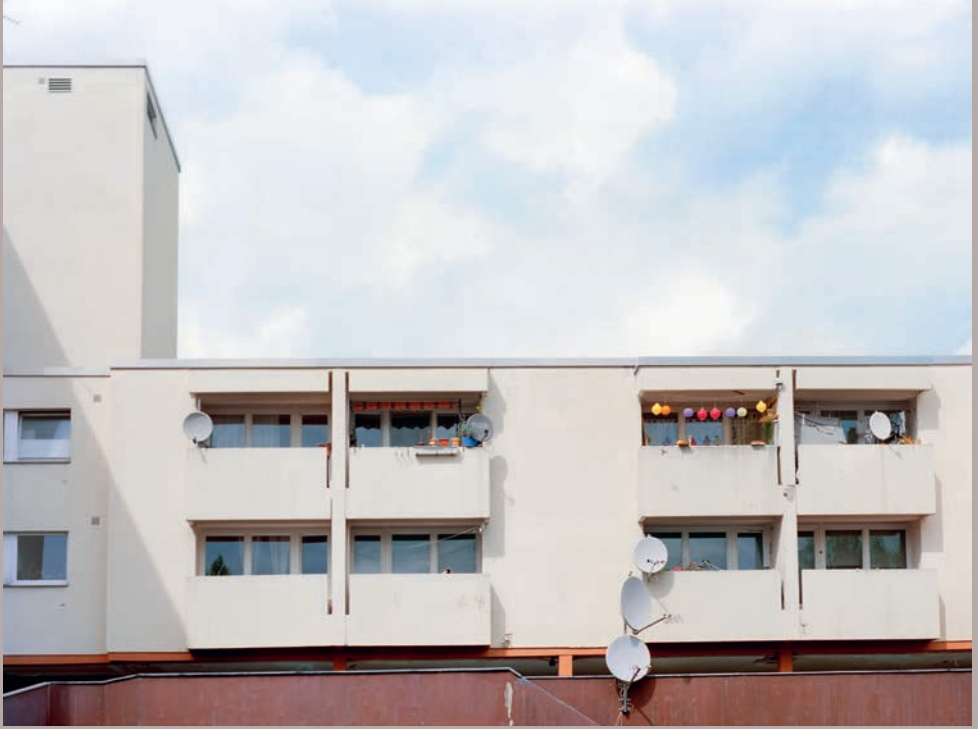
Rückansicht Kurfürstenstraße 145. Der Abriss des Gebäudes steht seit einigen Jahren im Raum. Einige Wohnungen werden von den Frauen für ihre Arbeit genutzt.
